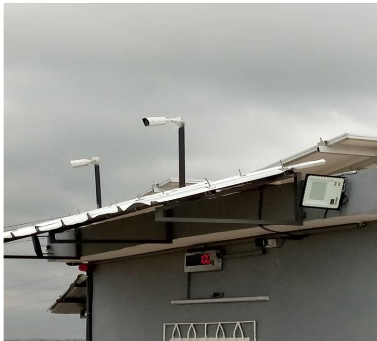
Sécurité du site par des cameras ( 10 cameras)
