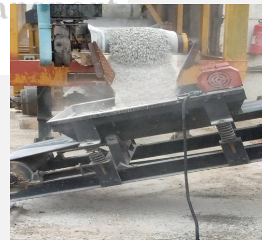
chute d'agrégats sur crible vibrant
