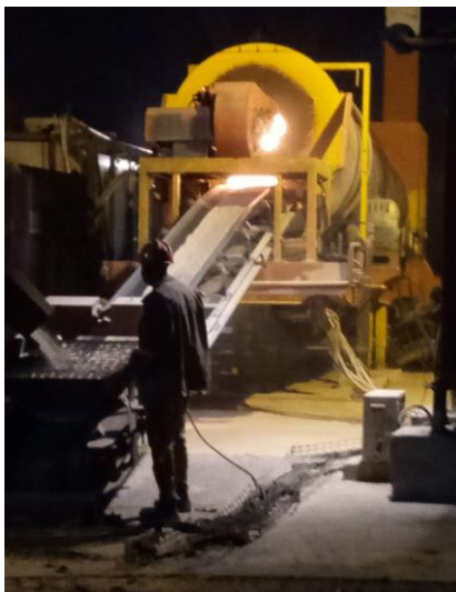
Conduite d'agrégats dans le Tambour sécheur enrobage
